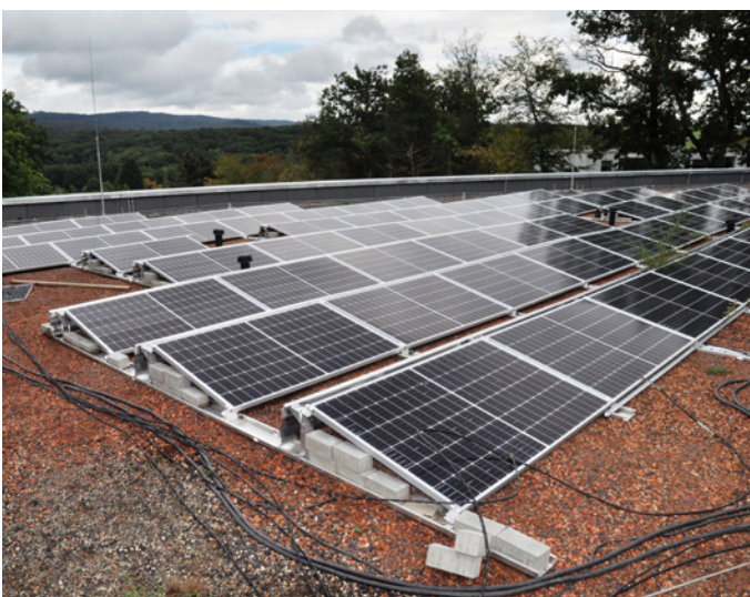
Auf dem Dach sorgt eine große Photovoltaikanlage für selberzeugten Strom.
